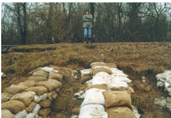
Az 1998. november 7-én éjszaka Tarpánál az országmentén megcsúszott töltés bordás megtámasztása
